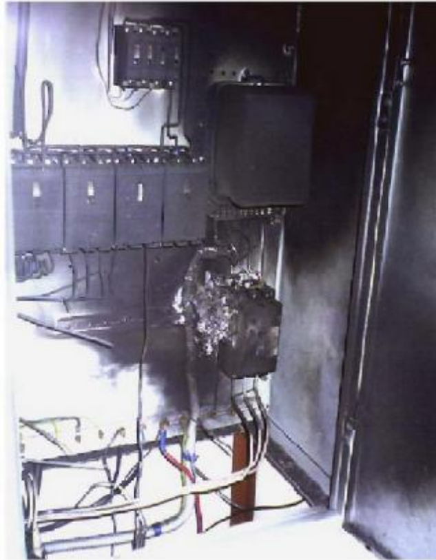
Рис. 1 Выход из строя варисторного УЗИП привел к пожару в ГРЩ.
